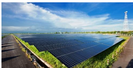
Рисунок 2. Солнечная электростанция (СЭС)
